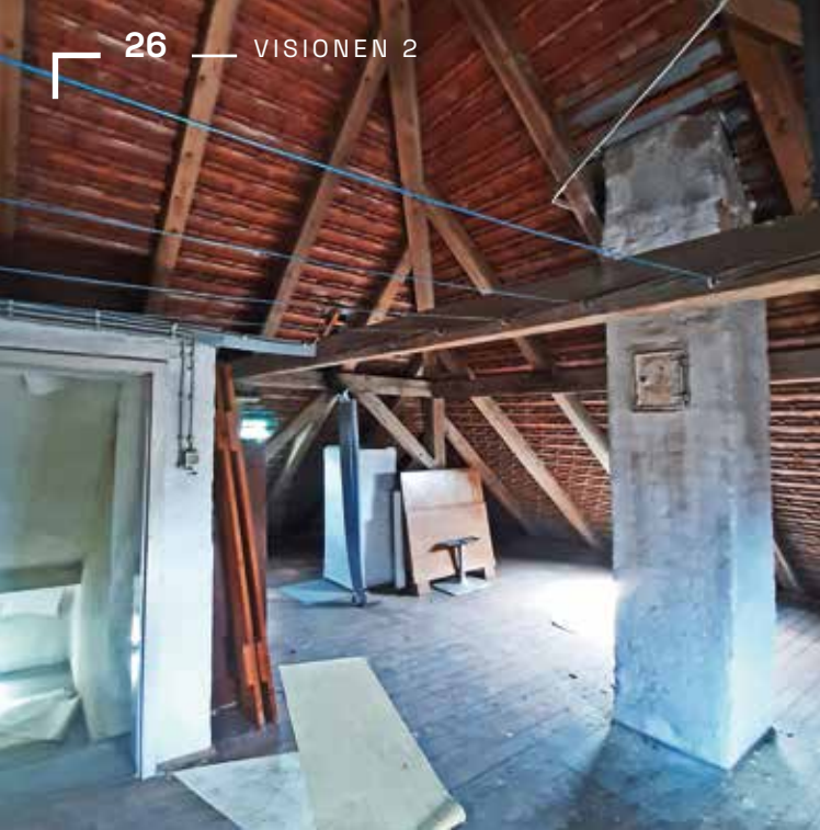
Das Dachgeschoss vor der Sanierung mit nicht mehr betriebs-sicherem Kamin
